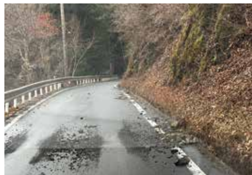
地盤がもろく所々で落石（兵越林道）
